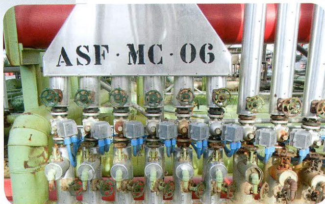
Detalle de los purgadores.
